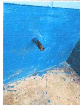
Foto 8: Sustrucción de llave en mingitorios
